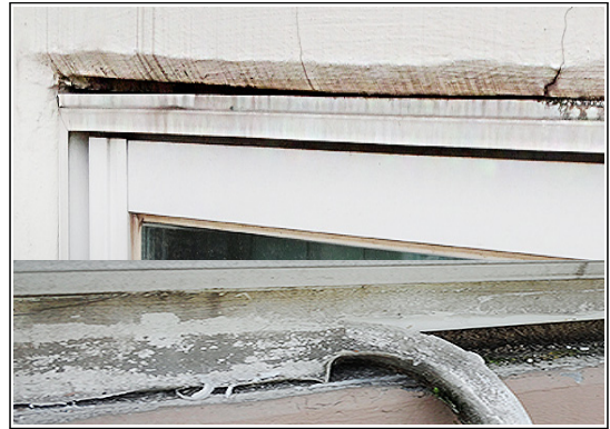
〈그림 1〉 코킹 미시공 및 탈락
