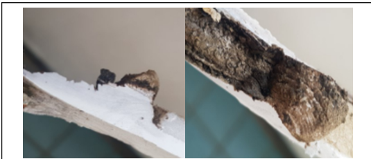
하부 고임목 썩은 상태 76)
